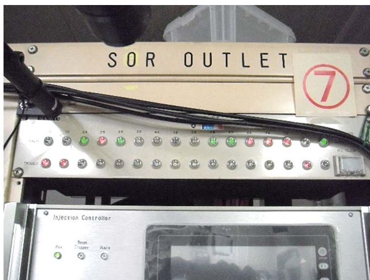
図2 フロントエンドバルブのステータス表示器
