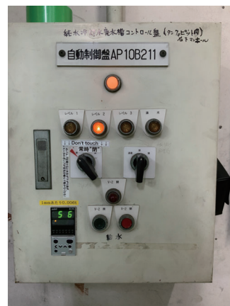
図1 放流槽制御盤。
