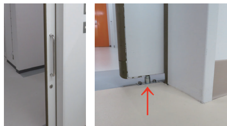
図1 取手と床に固定された棒により扉が開ききらない
