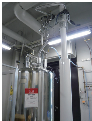
写真1 NMRマグネットと液体ヘリウム蒸発防止装置
